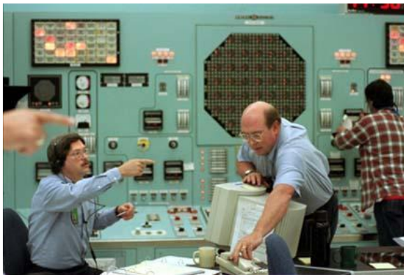
Рисунок 1. Блочный щит управления АЭС
